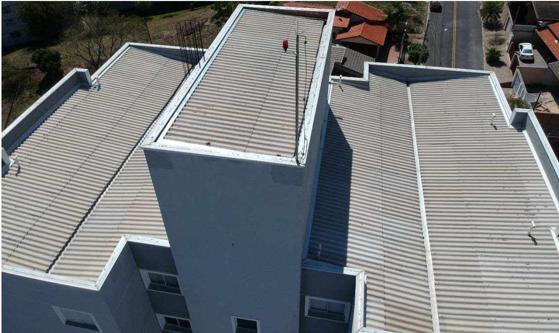
Figura 1 – Subsistema de captação (Arquivo do autor)
