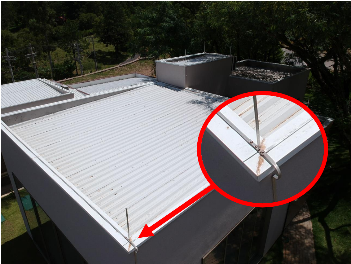
Figura 2 – Corrosão nas conexões (Arquivo do autor)
